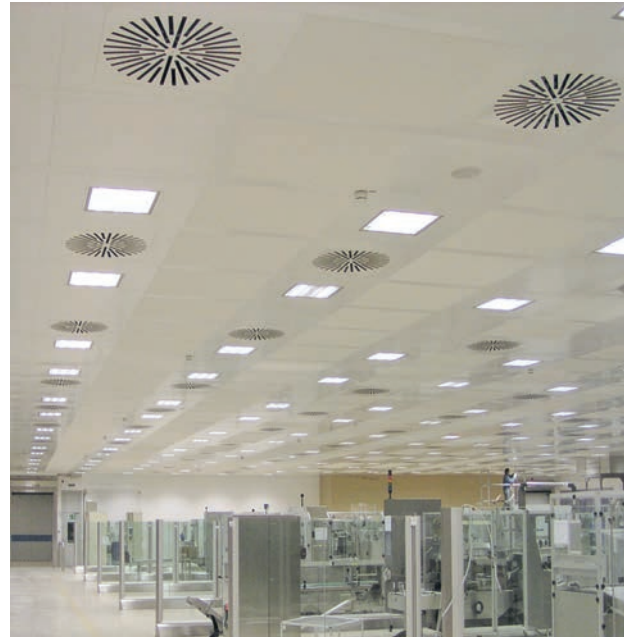
Beispiel für das ceil-tek Deckensystem auf einer großen Fläche
